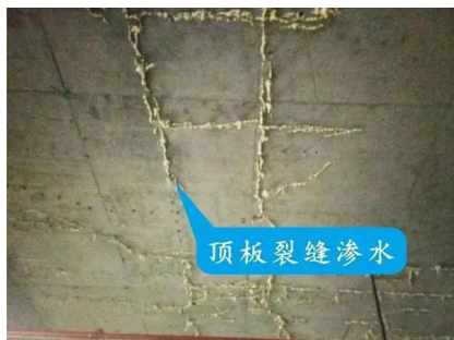
图2 地下室渗漏示意图
