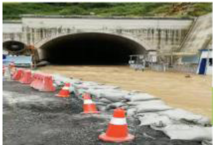
图 2 隧道揭露暗河涌水
