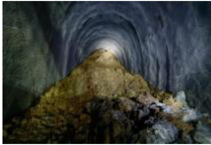
图 1 隧道揭露溶洞突泥、塌方
