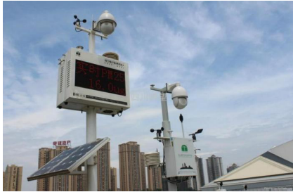
图1 防大气污染扬尘噪声监测设备
