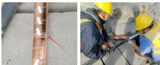
图1 故障漏缆外导体变形褶皱示意图
