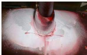
图 2 小口径管线连接处发生金属疲劳
