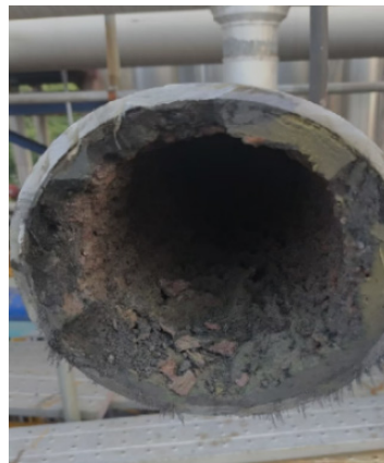
图 2 某常减压装置空冷入口管线铵盐结晶情况
