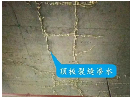
图2 地下室渗漏示意图
