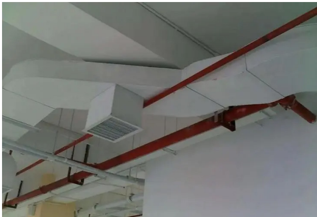
图1 空调管道和风道
