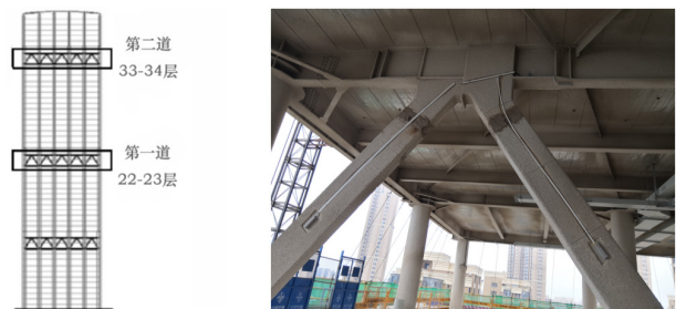
图7 伸臂桁架布置及应变计安装
