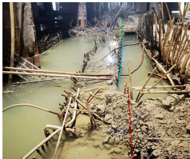
图 7 漏水点地墙主筋情况
