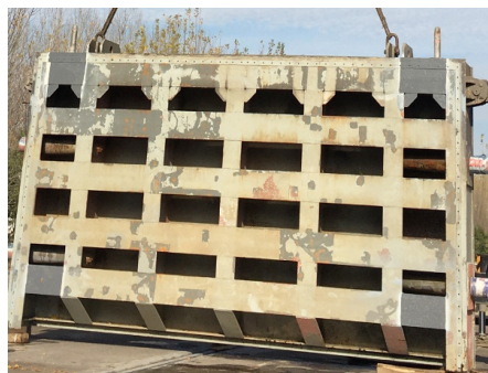
图1: 闸门锈蚀状况
