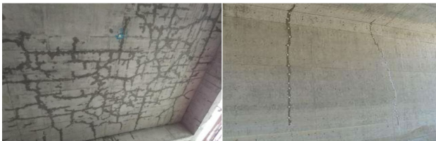
图 3 混凝土水化反应造成砼裂缝
