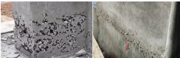
图 1 振捣不实造成的麻面
