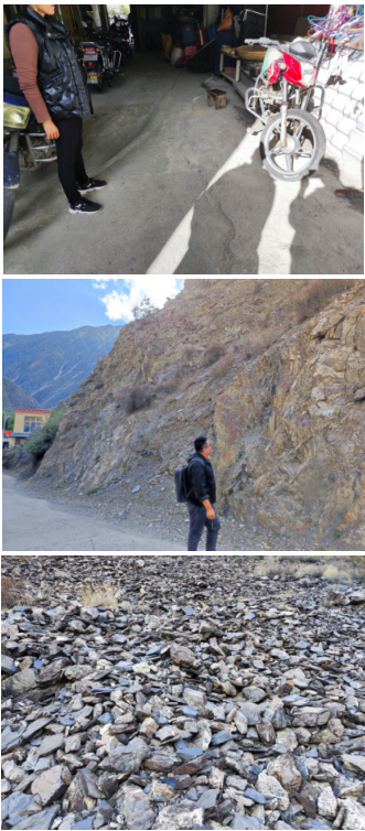
图 2 岩石表面裂缝和剥落
