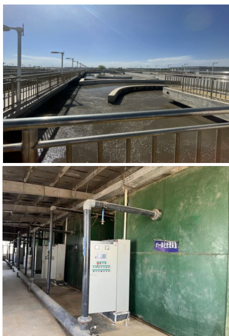
图1：某产业园区污水处理厂污水处理设施设备
