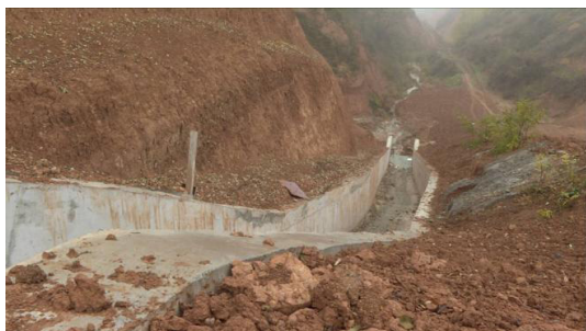
图2 农村地区水土流失严重
