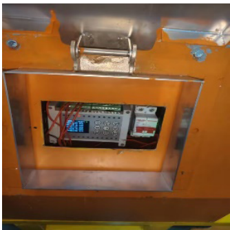
图 27 矩阵式钻孔机器人 plc 控制系统
