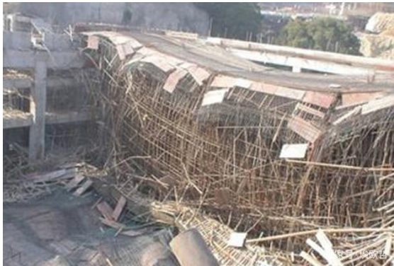
图 2 高支模事故危害
