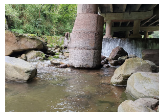
图1 防护体受撞破损
