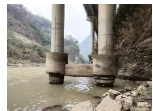
图2 桩身破损露筋
