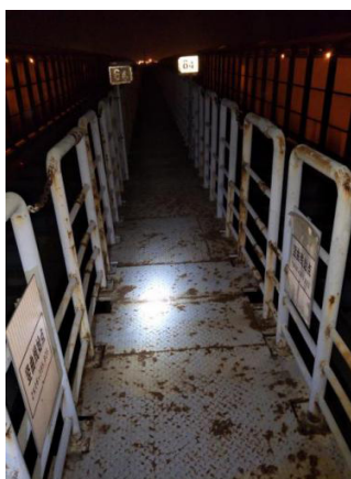
图1 疏散平台涂装维护前
