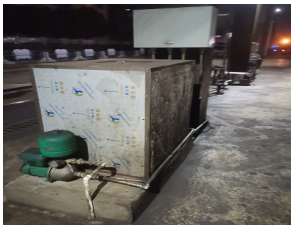
水箱和二次增压泵
