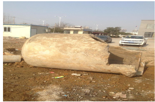
图 2 塌陷处污水管
