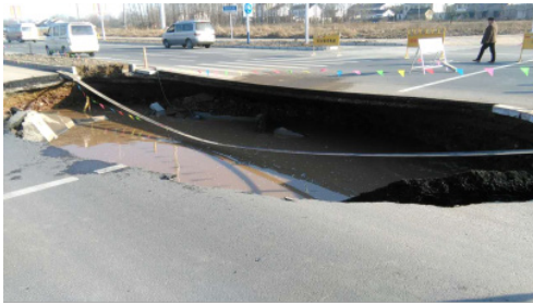
图 1 道路塌陷现场状况
