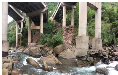
图10 水麻高速公路普洱渡立交桩基处治前
