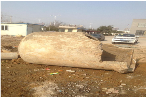
图 2 塌陷处污水管
