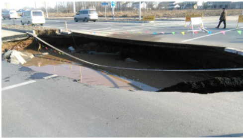
图 1 道路塌陷现场状况
