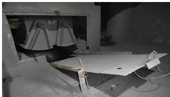
图 2 料仓下料闸接料板
